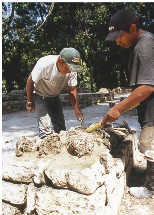
De vez en cuando los albañiles hacen una mezcla de cemento que no se solidifica correctamente. Estos trabajadores tuvieron que dismantelar los muros que habían restaurado y volverlos a hacer.
