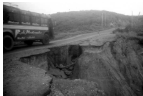
Figura 46. Deslave en una carretera de Nicaragua kyapa.tripod.com/elniyoycarreteras
