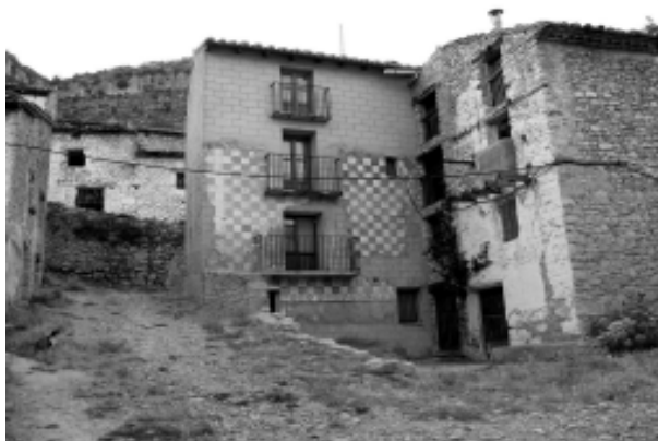
Figura 54. Casas con peligro de derrumbe. naturatge.blogspot.com/2007_07_01_archive.html
