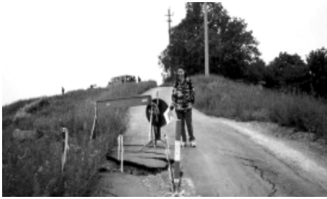
Figura 21. La presencia de grietas semicirculares, el hundimiento de algunas partes de la carretera y los postes desalineados, son los principales síntomas de inestabilidad que se pueden observar en esta región
