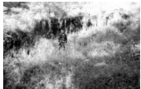
Figura 20. La formación de escarpes o escalonamientos son un claro síntoma de la inestabilidad de las laderas.
