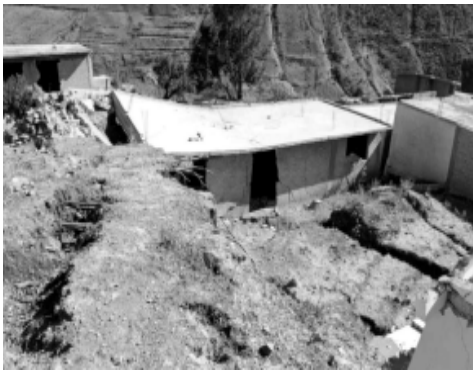
Figura 22. Rompimiento y movimiento en bloques de un deslizamiento con mecanismo traslacional
