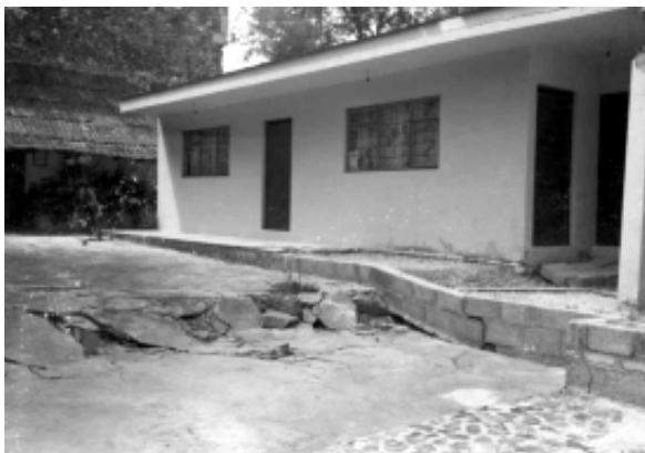
Figura 18. Abultamientos en las superficies naturales y artificiales son indicativos de inestabilidad.
