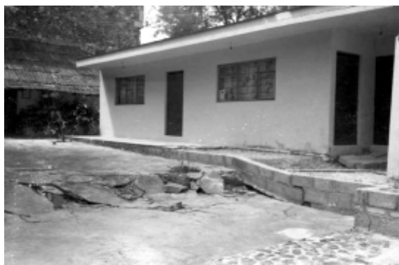
Figura 16. El rompimiento de muros y pisos es un indicio de inestabilidad
