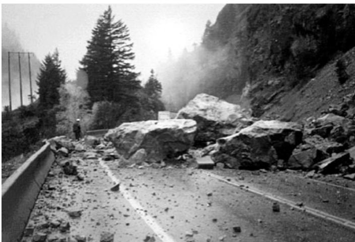
Figura 3. Los caídos o derrumbes ocurren con frecuencia en las carreteras
