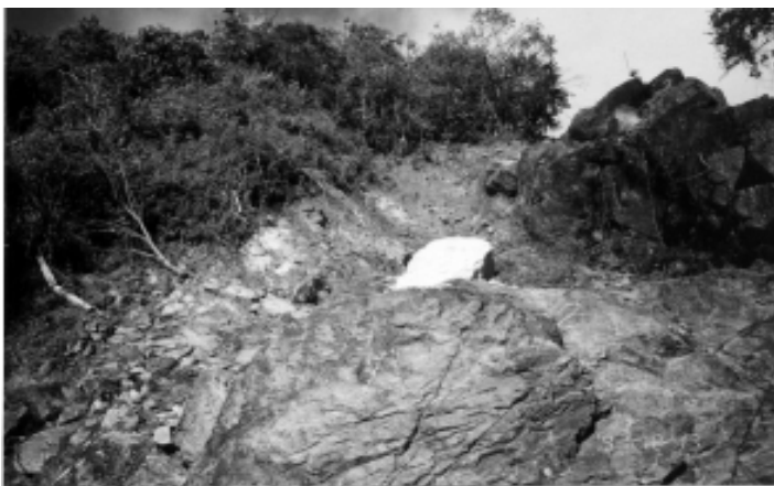
Figura 41. Generación de caídos o derrumbes locales en la parte alta de Acapulco debido al huracán Pauline
