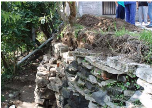
Foto 32. Talud inestable propenso a derrumbe y a deslizarse hacia el cauce de la barranca, presenta socavación y erosión alto.
