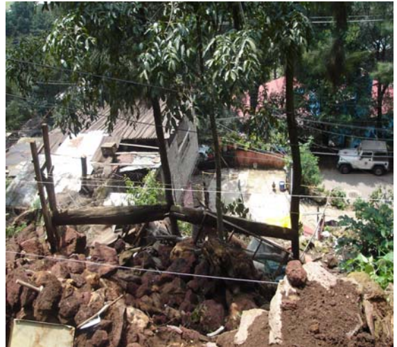
Foto 278.- Derrumbe de barda de piedra acomodada al fondo se observa la casa.
