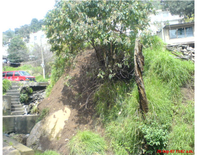
Foto 41. Vivienda ubicada a 8 m de la barranca, la cual presenta deslaves y grietas, así mismo los árboles presentan las raíces expuestas.
