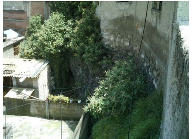
Foto 23. Dentro de esta vivienda se encuentra un deslave de un talud en dicha vivienda habitan 6 personas.
