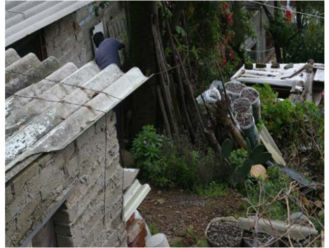
Foto 51. Vivienda habitada por 3 personas la cual esta expuesta a un deslave por el talud que se encuentra a espaldas de la casa y la parte delantera la cual esta dividida por un corte de talud con una altura de 12m.
