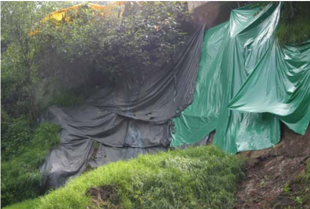
Foto 150. Deslaves ocasionados por las fuertes lluvias y construcciones en taludes.
