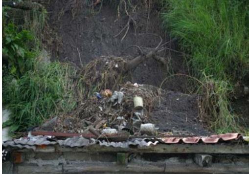
Foto 1. Deslave de talud arriba de una vivienda habitada por 4 personas, por la saturación de terreno.
