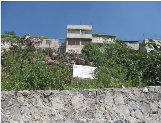
Foto 243.- Vista de la ladera y talud desde calle Prolongación Ingenieros Topógrafos. Se aprecia un letrero con la leyenda "Área Peligrosa"
