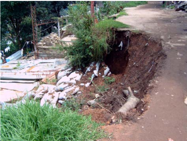
Foto 148. Zonas de desgajamiento, ocasionado por la erosión de las laderas y asentamientos humanos irregulares, generando un alto riesgo
