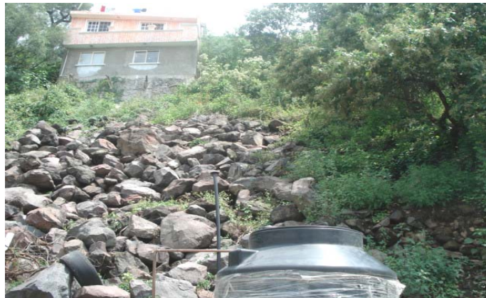
Foto 258. Casa a la orilla de talud, se observa derrumbe y cavidades.
