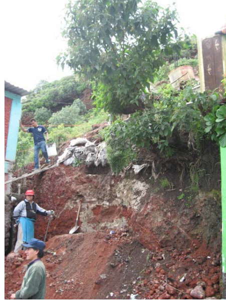
Foto 219- Desgajamiento del talud para ampliar la construcción de una casa habitación.
