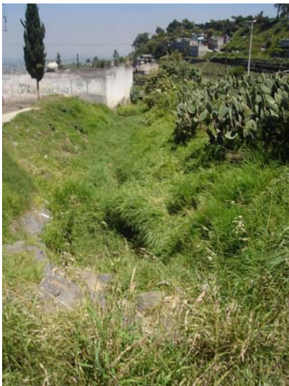
Foto 301. Cauce natural al fondo vivienda que invade el talud del mismo
