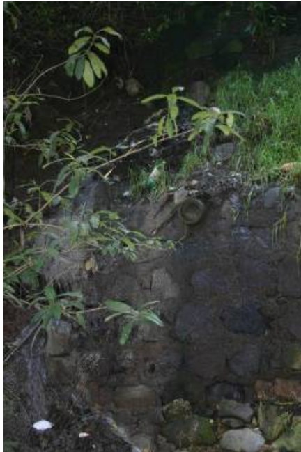
Foto 121- Tubo de agua residual dirigido a la barranca
