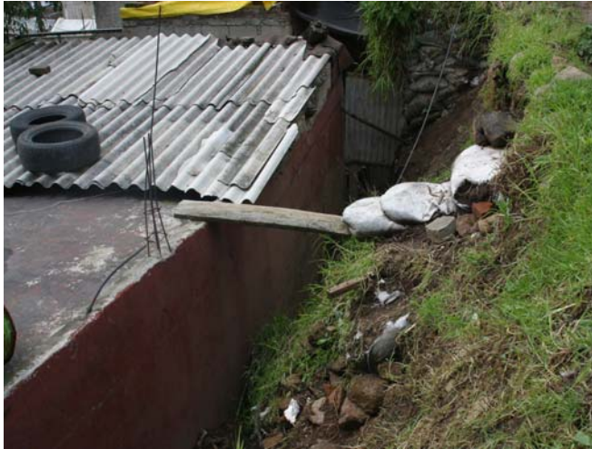
Foto 50. Continuo deslave por aguas pluviales en el hombro de la barranca poniendo en peligro una vivienda habitada por 5 personas.
