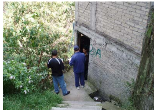
Foto 35. La vivienda se encuentra a 3 m de la barranca la cual tiene deslaves de talud.
