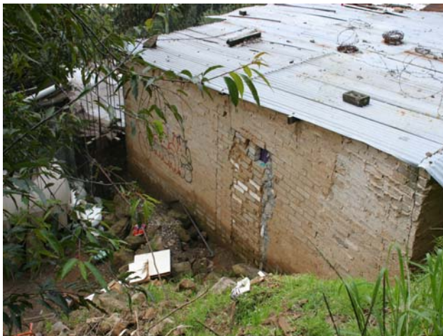
Foto 52. El talud que se encuentra detrás de esta vivienda se presenta grietas por los frecuentes deslaves de aguas pluviales
