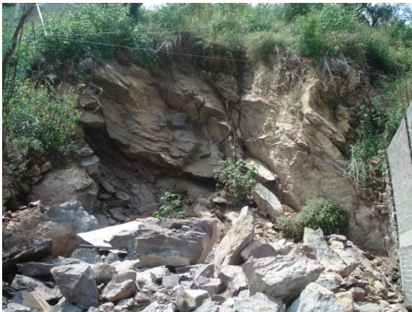
Foto 250. Talud con derrumbe.
