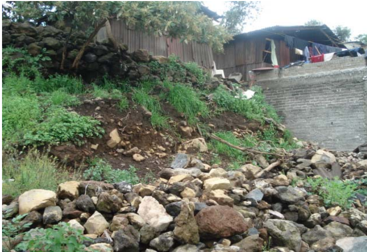
Foto 255. Erosión del talud.
