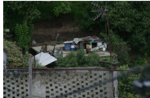
Foto 4. Talud con un severo deslave que afecta a 5 viviendas.
