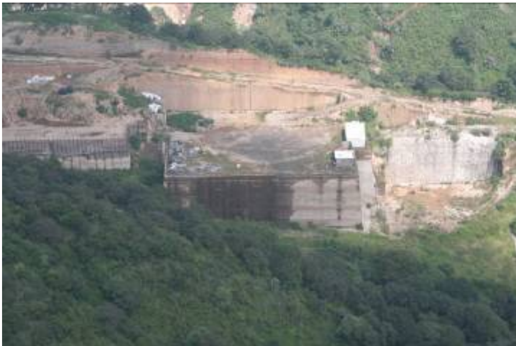
Foto 128.- Ejemplo del deterioro de las laderas de la barranca por las construcciones que se están realizando
