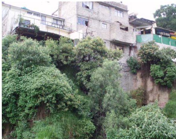
Foto 13. Deslave de talud afectando a 5 viviendas habitadas por 16 personas, por causa de la descarga de aguas negras de las viviendas aledañas a la barranca.
