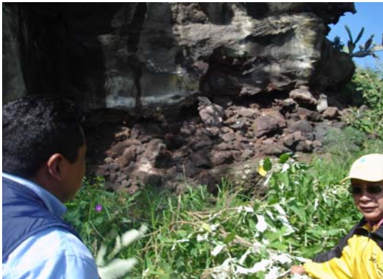
Foto 282. Piedras sueltas en la base del talud.
