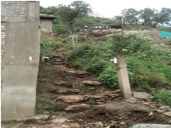
Foto 253. Andador corredor de agua pluvial, socavación baja, propenso a derrumbe.
