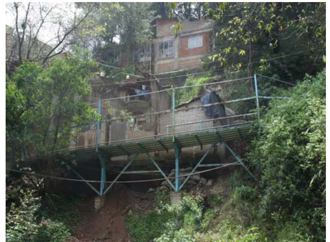
Foto 53. El puente que se encuentra a 10 m de distancia de las viviendas, en la parte baja presenta deslave y grietas.
