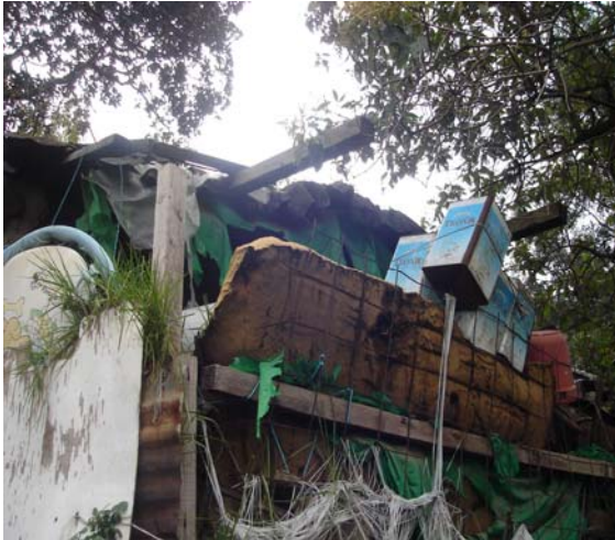
Foto 277.- Vivienda con basura en su techo.
