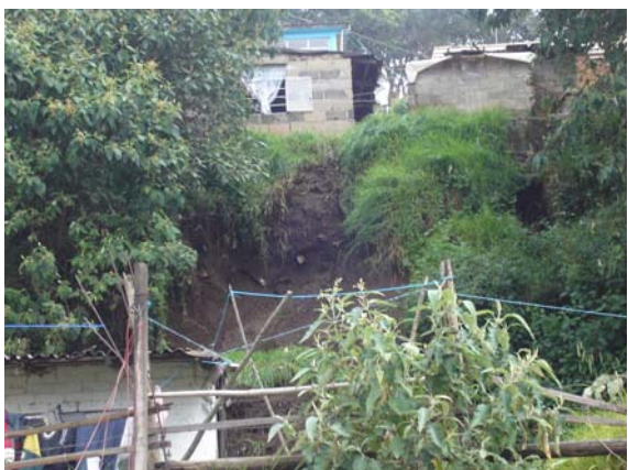
Foto 275.- Derrumbe de talud con un árbol de tepozán
