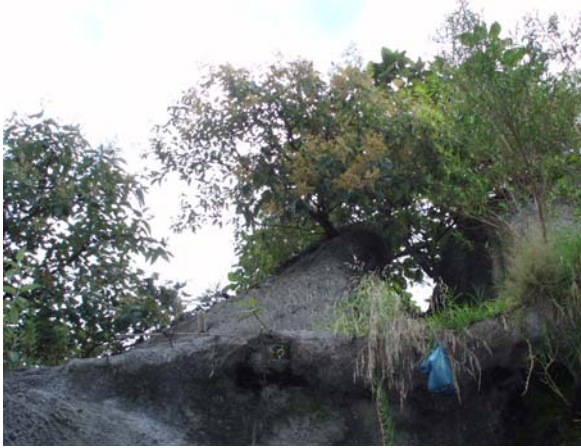
Foto 17. Los deslaves constantes del talud provocan formaciones huecas que ponen en peligro algunas viviendas.
