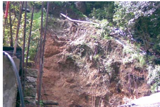
Foto 10. Deslaves en el talud que afectan a 2 viviendas, las cuales se encuentran en un riesgo latente.
