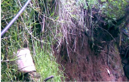
Foto 7. Socavación del talud con relleno de costaleras las cuales se encuentran deterioradas.
