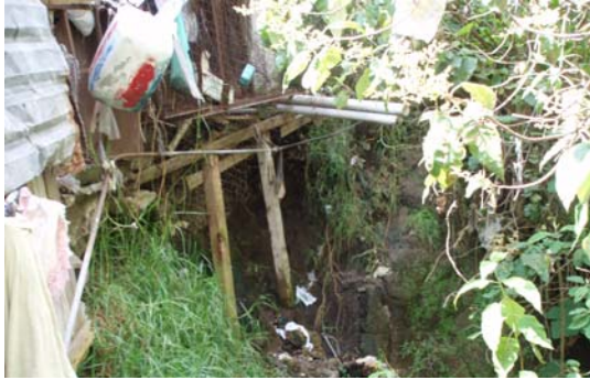
Foto 30. Deslave de talud con peligro de caerse 4 viviendas habitadas por 17 personas.
