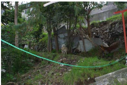
Foto 5. Deslave de talud y exposición de raíces de los árboles que se encuentran en la zona.
