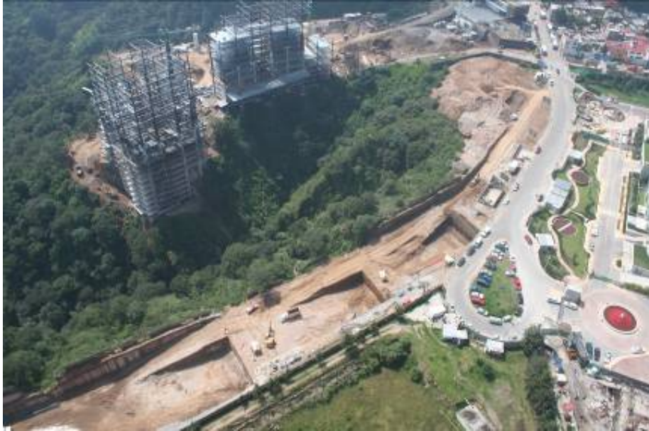
Foto 127.- Afectación a los taludes por la construcción de un desarrollo inmobiliario
