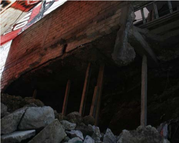
Foto 24. Talud inestable con grietas deslave una vivienda habitada por 6 personas.
