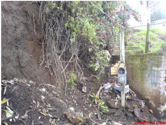
Foto 42. Muros de una vivienda se encuentra con grietas por el deslave que se observa a 30 cm.
