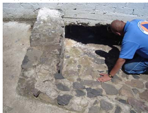
Foto 304. Construcciones sobre el cauce natural.
