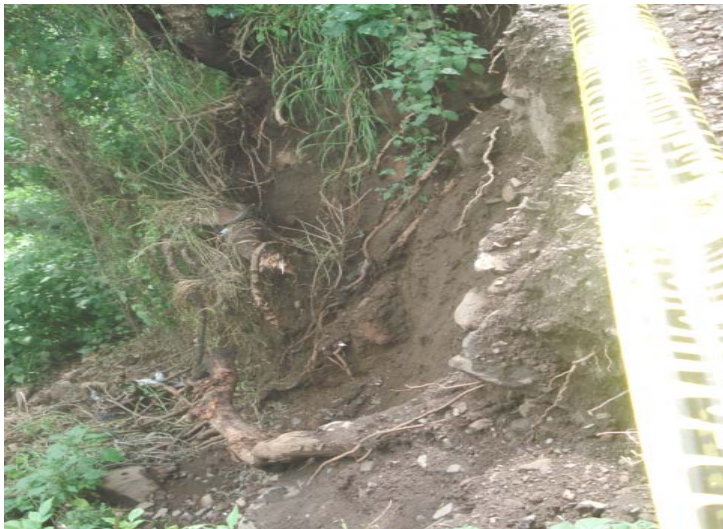
Foto 256. Socavación y deslave.
