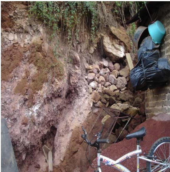
Foto 279.- Derrumbe de barda de piedra
