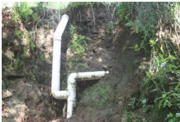
Foto 110.- Ductos de aguas residuales
