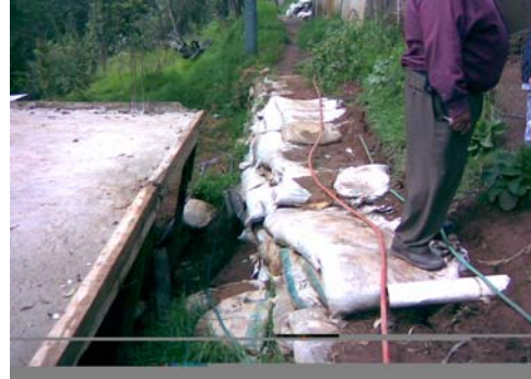
Foto 8. Socavación del talud con relleno de costaleras las cuales se encuentran deterioradas.
