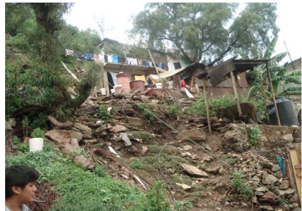
Foto 254. Socavación de talud, propenso a derrumbe.
