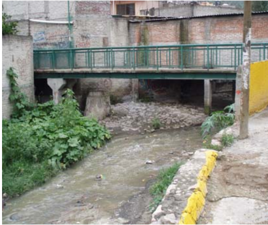
Foto 172. Orellana Vista del cauce que presenta aguas negras ubicado junto a las viviendas.
