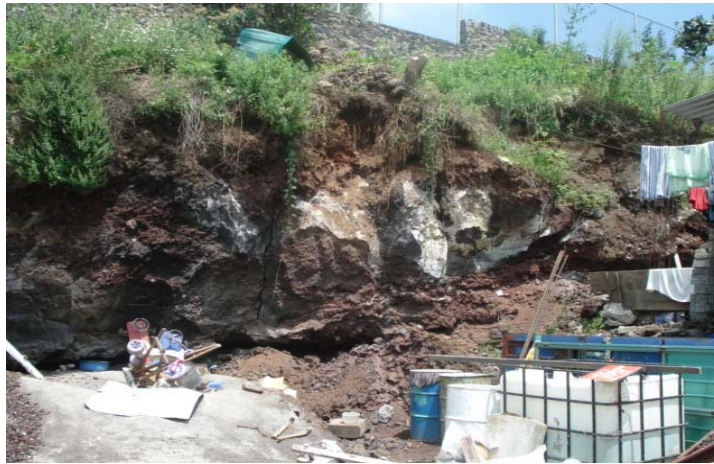
Foto 252. Talud con cavidades, socavada.
