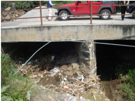
Foto 297 Depósito de tierra y residuos sólidos en el cauce.
