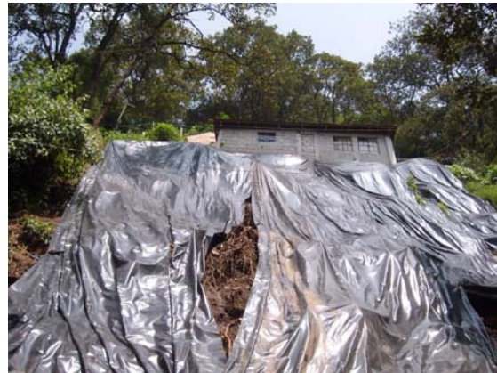
Foto 59.- Sitio al que le fueron colocadas lonas para evitar el deslizamiento de material
