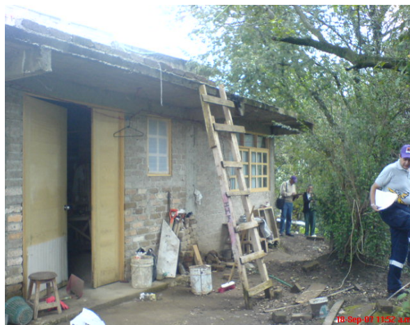
Foto 39. Vivienda que se encuentra a 10 m de la barranca con peligro de deslave.
