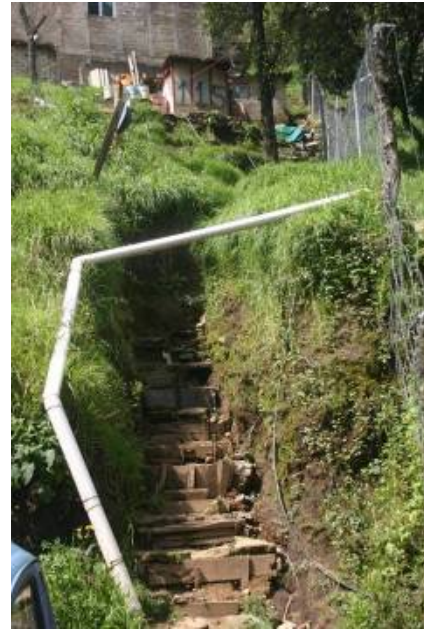
Foto 120.- Tubería de PVC que conduce aguas residuales hacia la barranca.
