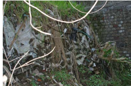
Foto 6. Socavación del talud con relleno de costaleras las cuales se encuentran deterioradas.
