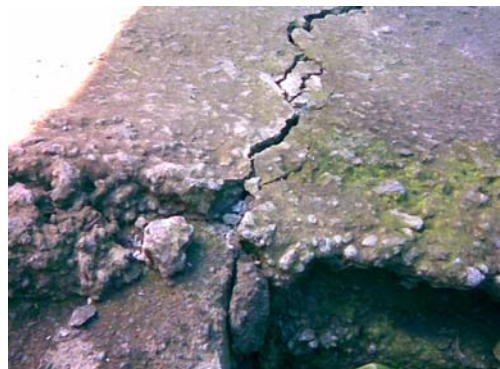
Foto 12. Las grietas se presentan en la mayoría de los taludes de la barranca a consecuencia de los deslaves.
