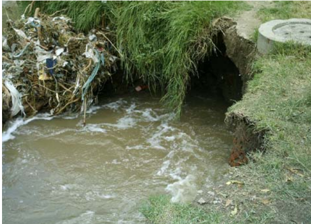
Foto 19. El cauce de la barranca presenta varias cavidades las cuales se tapan con la cantidad de residuos sólidos que son desechados por las viviendas aledañas.
