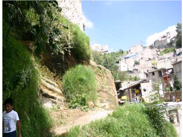
Foto 25. Deslave de talud por escurrimiento de aguas pluviales.
