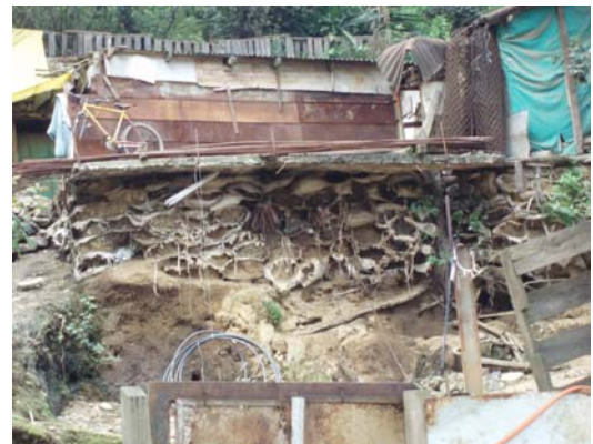
Foto 268. Talud socavado, construcción propensa al derrumbe.
