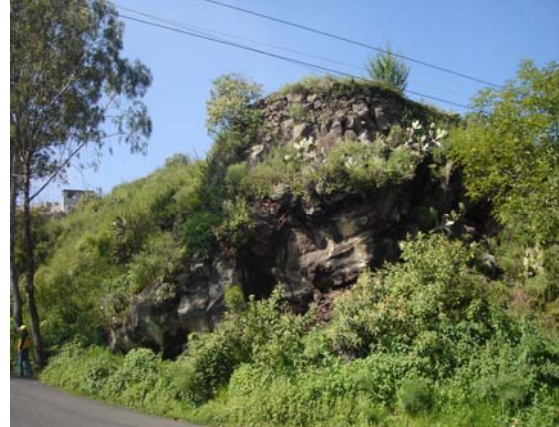
Foto 281. Talud de roca colindante con la carretera principal a San Lorenzo Tlacoyucan.
