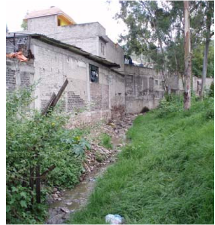
Foto 173. Orellana Se observa el cauce así como los residuos sólidos.
