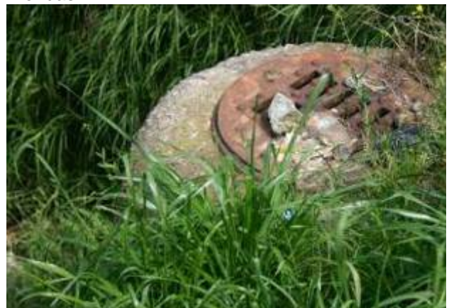
Foto 138.- Presencia de colectores marginales en la zona
