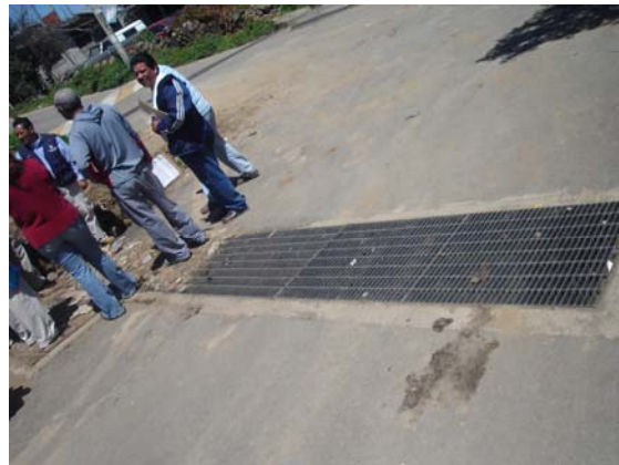
Foto 291. Existen pozos de absorción conectados a la red de drenaje los cuales requieren de mantenimiento.
