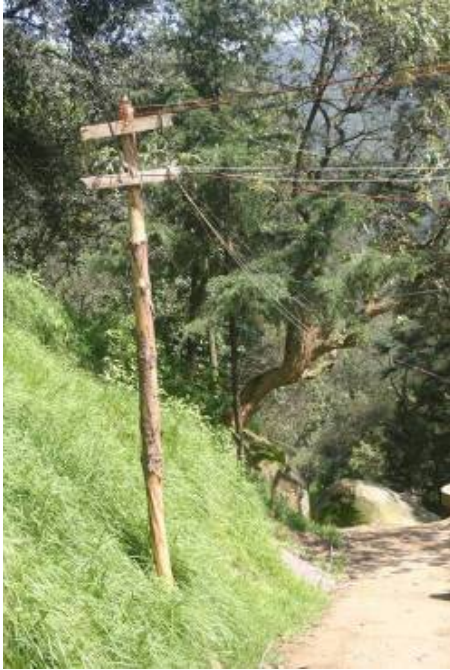
Foto 119.- Instalaciones informales para sostener los cables de electricidad
