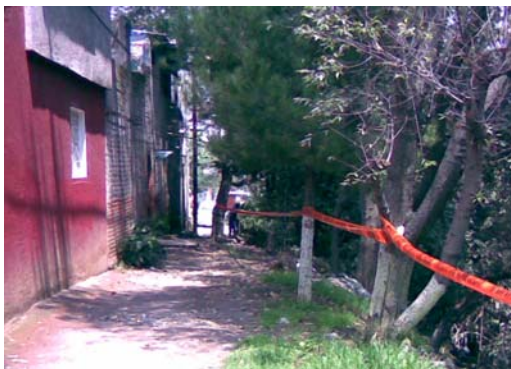
Foto 11. El talud que se encuentra junto a estas viviendas presenta grietas.
