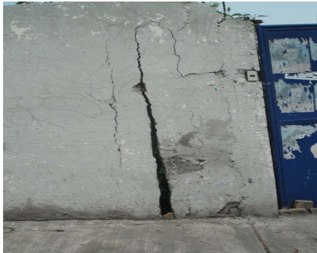
Foto 249. Grieta del predio de Sistema de Aguas, que ha provocado humedad en el predio contiguo.
