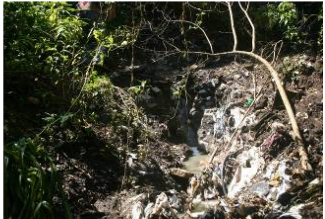
Foto 118.- Presencia de la basura en el cauce de la barranca
