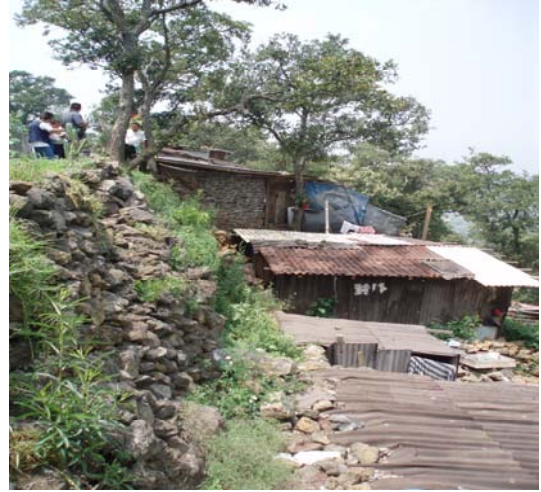
Foto 270. Construcciones propensas al derrumbe.
