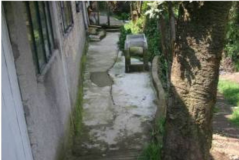
Foto 124- Pasillo de una vivienda que está cuarteado y sostenido por los árboles de la zona
