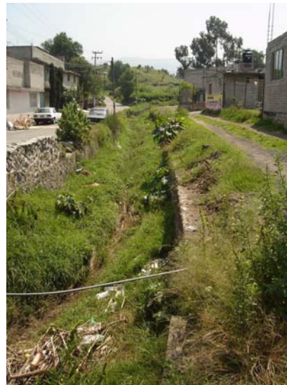
Foto 296. Se requiere de mantenimiento del cauce para la circulación de los escurrimientos durante las lluvias.
