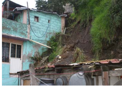
Foto 2. Deslave del talud a 2 m de distancia de una vivienda habitada por 4 personas.
