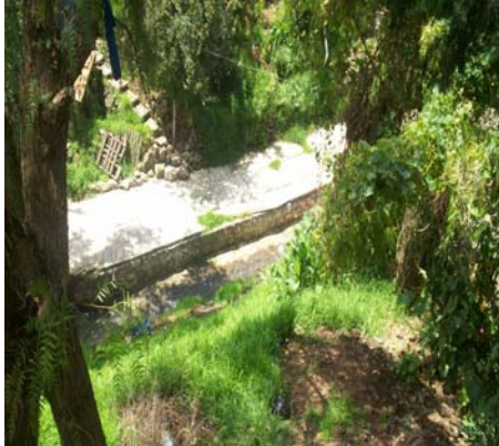
Foto 170. Barranca Armella Vista del talud en donde se observa el suelo erosionado.
