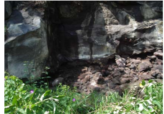
Foto 283. Fragmentación de rocas y filtración en la base del talud.
