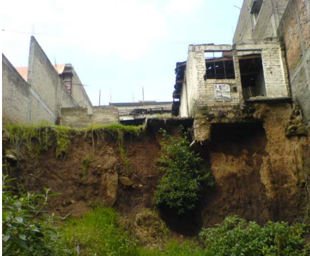
Foto 40. Casa habitación abandonada la cual se encuentra a 15 m de altura, donde el talud se muestra agrietado y con escurrimientos de agua.
