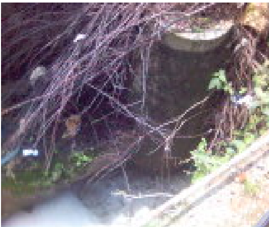
Foto 48. El cauce de la barranca es de aguas negras las cuales llevan residuos sólidos.
