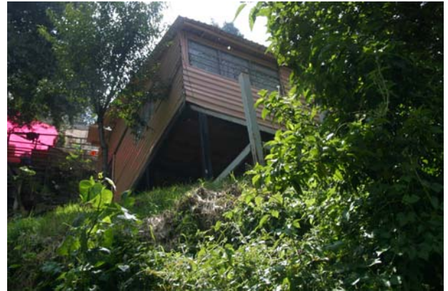
Foto 157. La realización de viviendas con materiales poco resistentes a las características de las laderas, genera un alto riesgo a desgaje de la tierra natural
