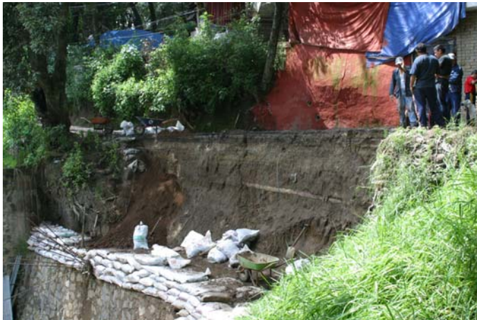
Foto 154. Taludes realizados de manera inapropiada, sobre laderas muy pronunciadas, tratando de mitigar el problema con costales.
