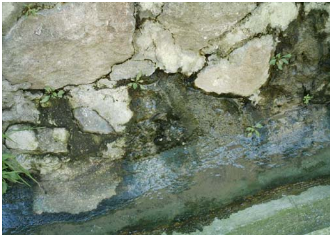
Foto 21. Los frecuentes deslaves y escurrimientos de aguas pluviales forman grietas en los taludes cubiertos de cemento.
