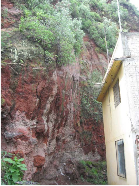
Foto 218.- Casa habitación en riesgo, por desgajamiento de talud, al esta ubicada a escasos 2 metros del talud del “Peñón Viejo”
